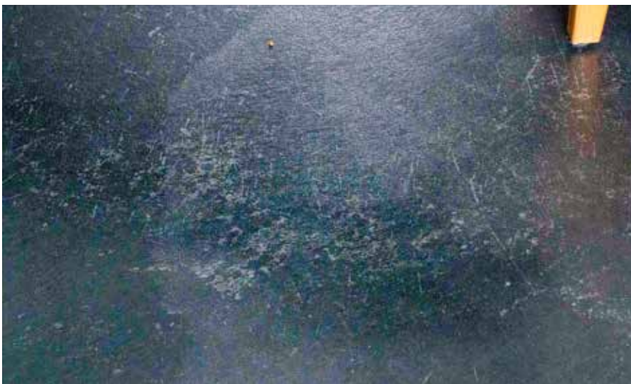
(1) Die PUR-Beschichtung eines dunkel eingefärbten Designstrichs wurde nutzungsbedingt beschädigt. Dies zeigt sich durch Weißbruch in der Beschichtung.
