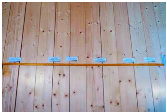
(4) Das Versiegeln mit Wasserlack ist bei genagelten Dielenböden eher ungeeignet. Dadurch können – wie hier – Blockfugen entstehen.
