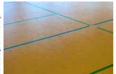
(2) Verstrichungen und Einbrennungen am Bodenbelag, z. B. in der PUR-Beschichtung eines Linoleumbelags, sind in Sporthallen kaum zu verhindern.
